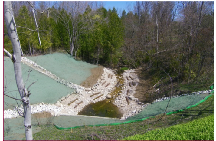
La zone en amont du nouveau ponceau de la rue Craig après la première phase d'aménagement paysager après- construction
